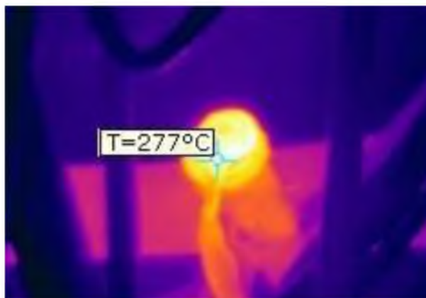
Рисунок 22. Пример обнаружения пожароопасного разогрева болтового контактного соединения
